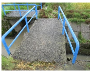
ブリッジの裏側鉄筋が見え
