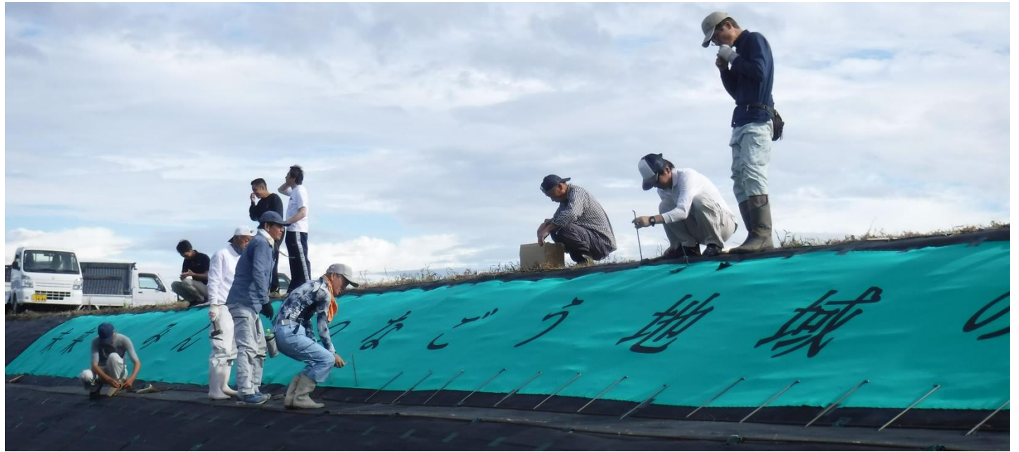
総勢13名でシンボル文字入り防草シート設置 (2024/9/15 小黒農地水環境を守る会)
