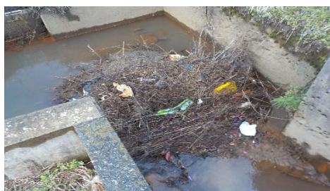
排水路の泥・枯れ草・ゴミ
